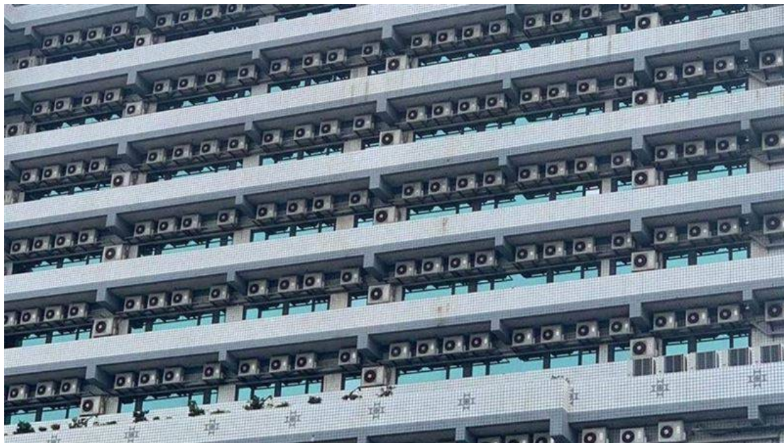
該棟住辦大樓外牆裝設292台室外機
